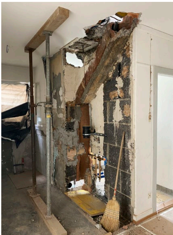
Die Liegenschaft Zurlindenstrasse 277 wurde 2023 gesamterneuert. Einzelne Wohnungen konnten während dieser Zeit nicht bewohnt werden. Foto Stiftung PWG
